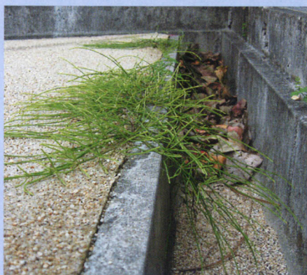
ハシピタン未施工
